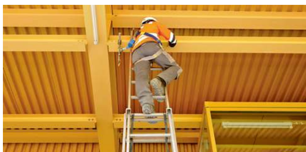
50 Persona messa in sicurezza con DPI anticaduta (punto di ancoraggio sopra la testa)
